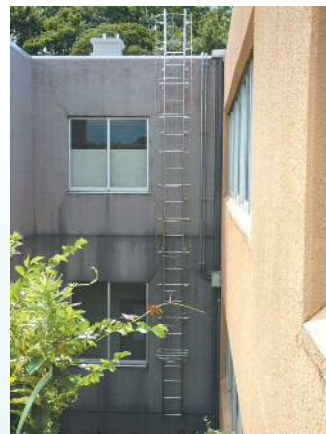
太陽光パネル 昇降塔屋トラップ
