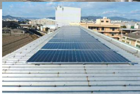
第2工場屋上にて発電中
