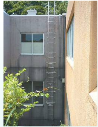
太陽光パネル 昇降塔屋トラップ
