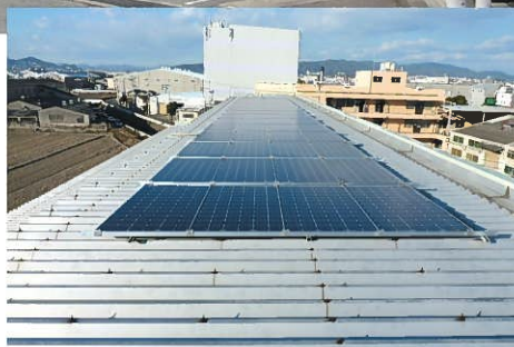
第2工場屋上にて発電中
